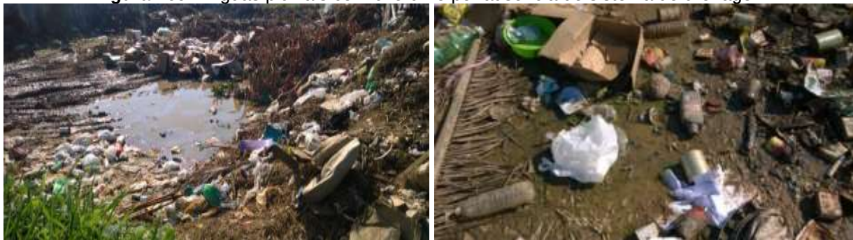
Figura 169 – Águas pluviais com chorume por ausência de sistema de drenagem
