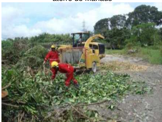
Figura 139 – Triturador de galhos utilizado no aterro de Manaus
