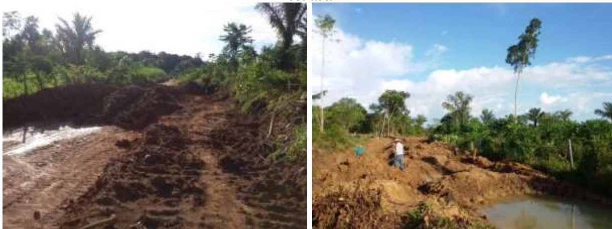
Figura 201 – Acesso à área de disposição final 1 intrafegável por conta de obras de melhoria na estrada
