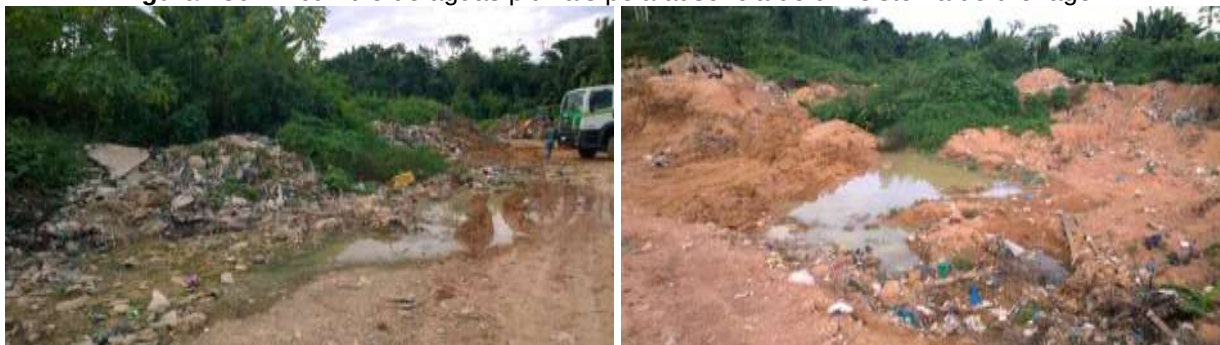
Figura 156 – Acúmulo de águas pluviais pela ausência de um sistema de drenagem
