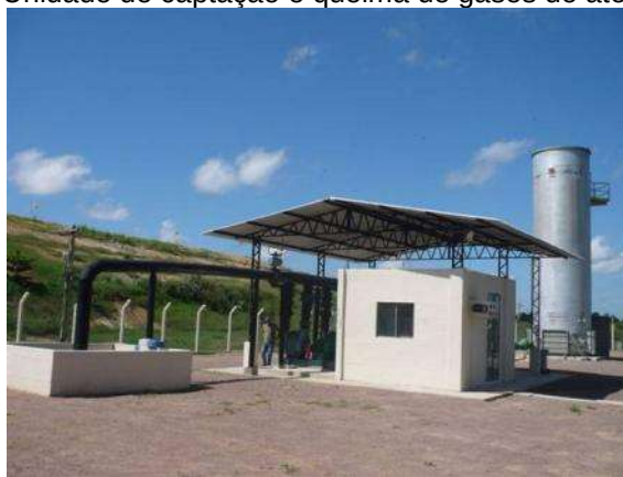
Figura 138 – Unidade de captação e queima de gases do aterro de Manaus
